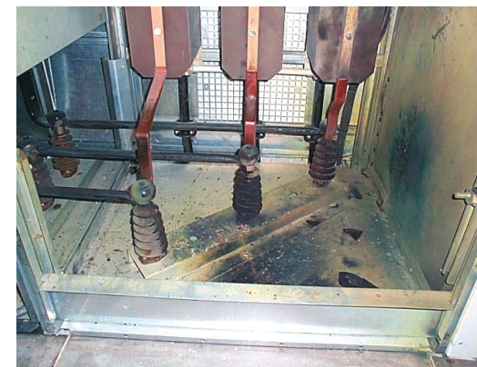
Bild 3. Fehlerfälle, die vermeidbar gewesen wären
