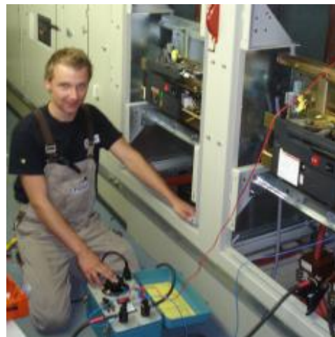
Bild 3: Primärprüfung während einer Wartung
