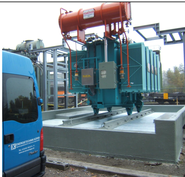
Bild 1: Blick auf den Transformator mit Feuerschutzrost
