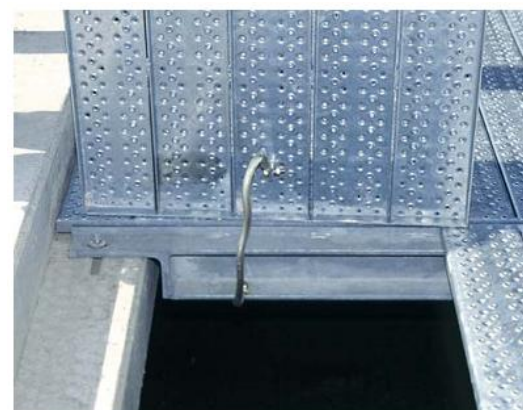
Bild 3: Revisionsklappe für Pumpe
